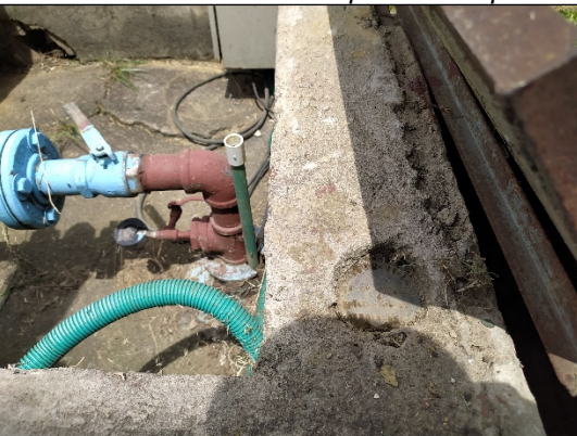
Foto No. 4. Tubería de producción y niveles
